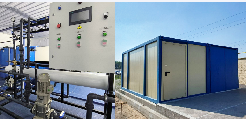
Рис. 2. Контейнерная станция мембранной очистки сточных вод от красителя
